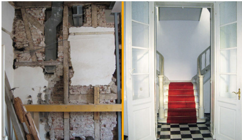
So sanierungsbedürftig ist es noch
